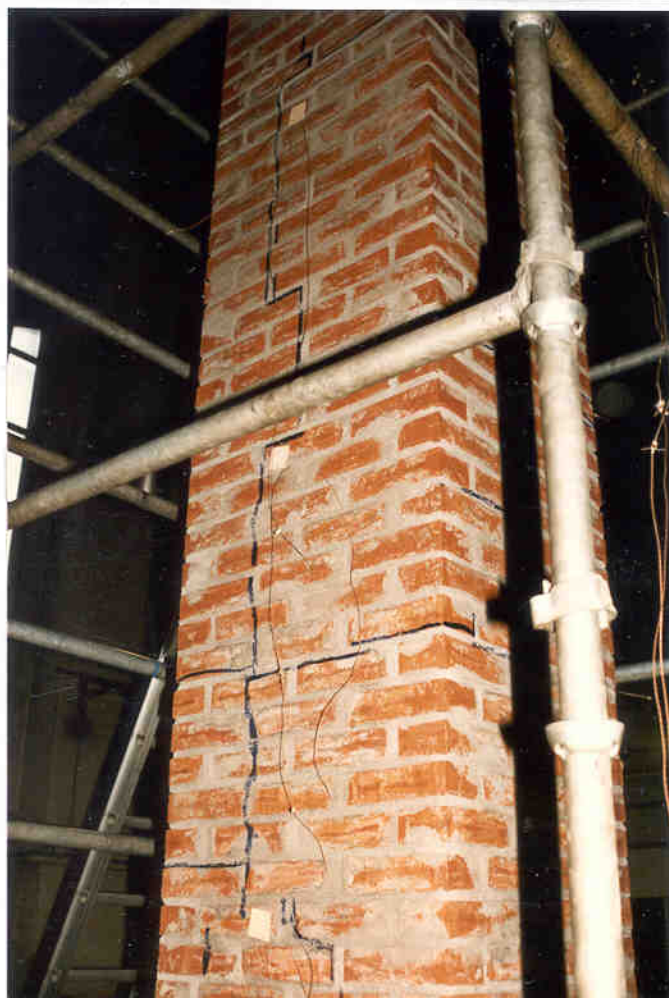
Foto 6: Pipens bakside fra Nivå C til Nivå E. Foto tatt etter at alle temperaturbelast- ninger i røykgassen var avsluttet.
