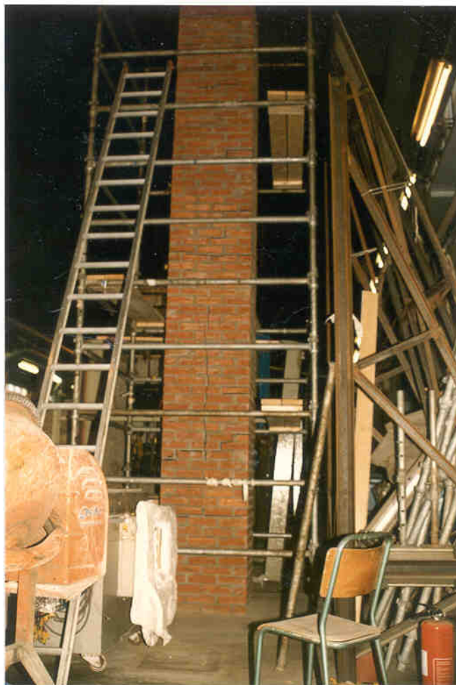
Foto 3: Pipens høyre side i hel høyde. Foto tatt etter at alle temperaturbelastninger i røykgassen var avsluttet.
