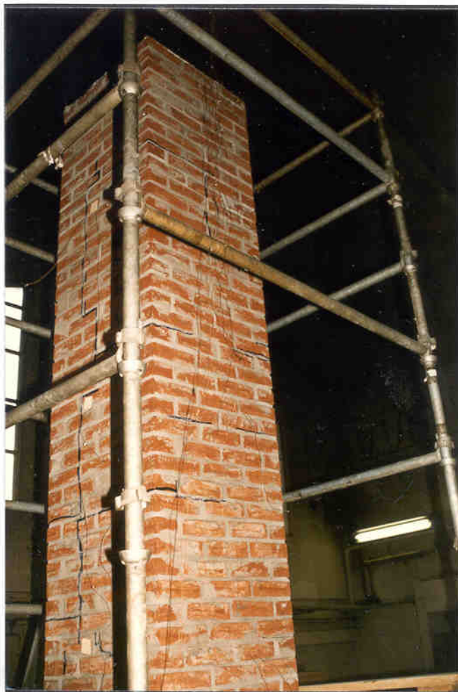
Foto 7: Pipens venstre og bakside fra Nivå C til topp pipe. Foto tatt etter at alle temperaturlastninger i røykgassen var avsluttet.
