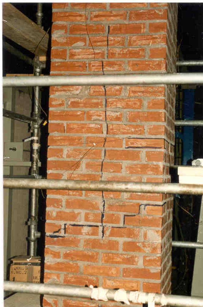
Foto 4: Pipens høyre side ved Nivå A. Foto tatt etter alle temperaturlastninger i røykgassen.
