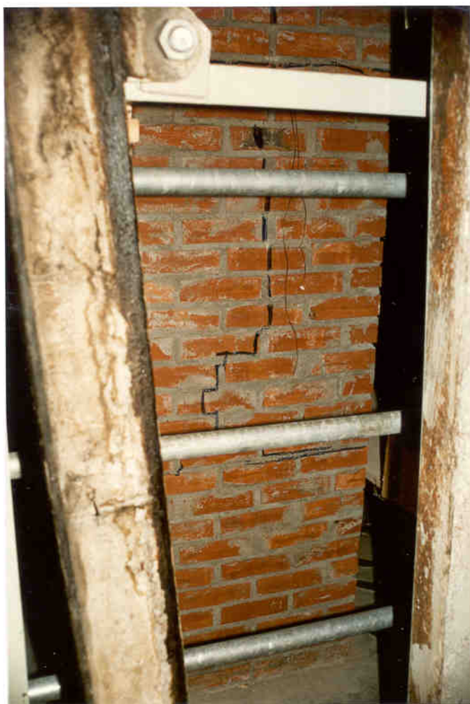
Foto 9: Pipens venstre side ved Nivå A. Foto tatt etter at alle temperaturlastninger i røykgassen var avsluttet.
